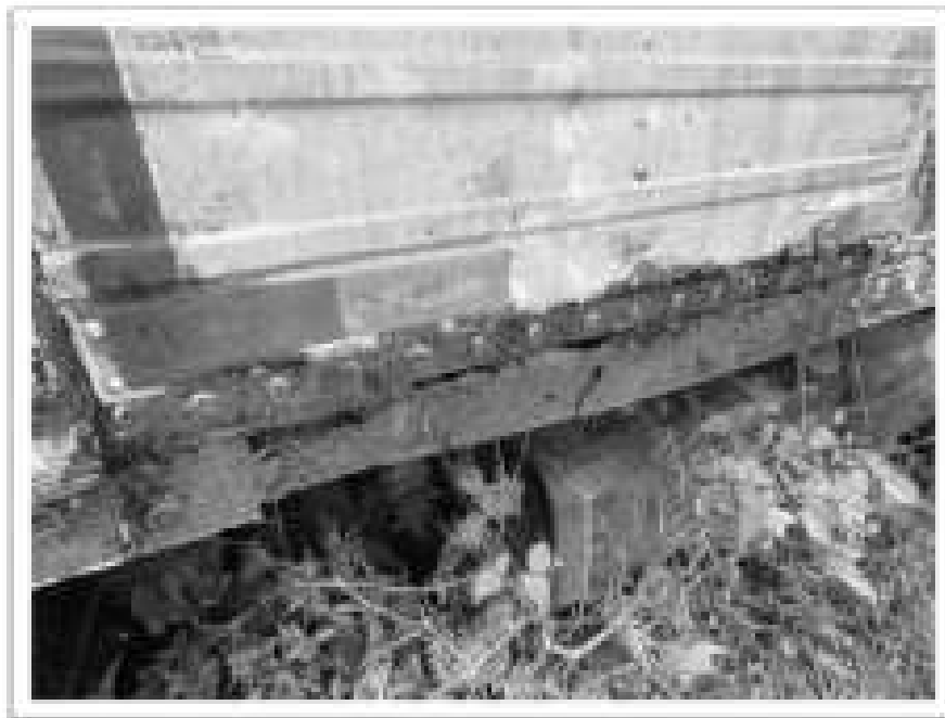
Foto 13 – Placa LYM-5401 – detalhe do estado de deterioração.
