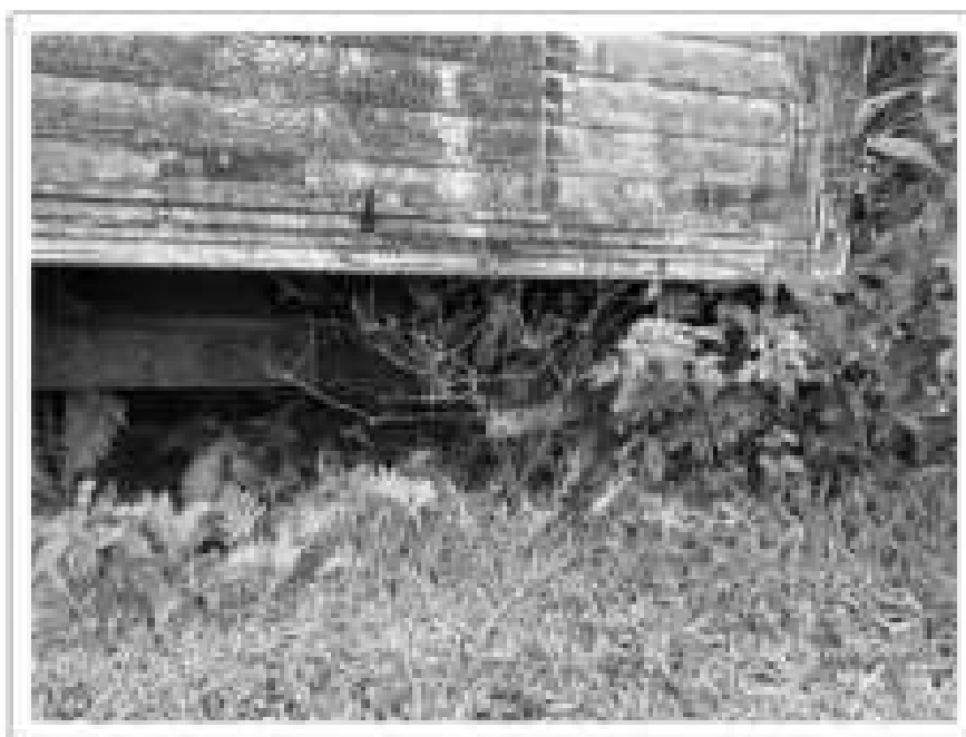
Foto 06 - MCM-8510 – estágio de deterioração em detalhe.
